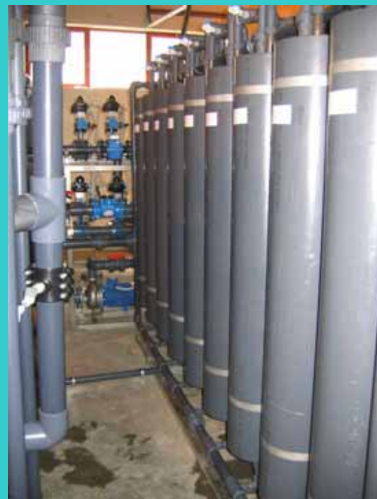
Общий вид микрофльтрационной установки на Московском нефтеперерабатывающем заводе
