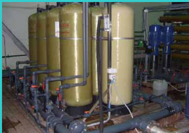
Блок ионообменных фильтров на Павлодарском нефтеперерабатывающем заводе
