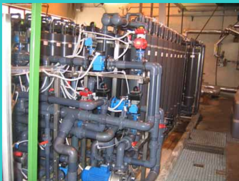
Циркуляционная насосная станция
