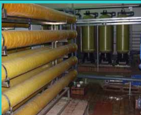
Блок обратноосмотического обессоливания на Павлодарском нефтеперерабатывающем заводе
